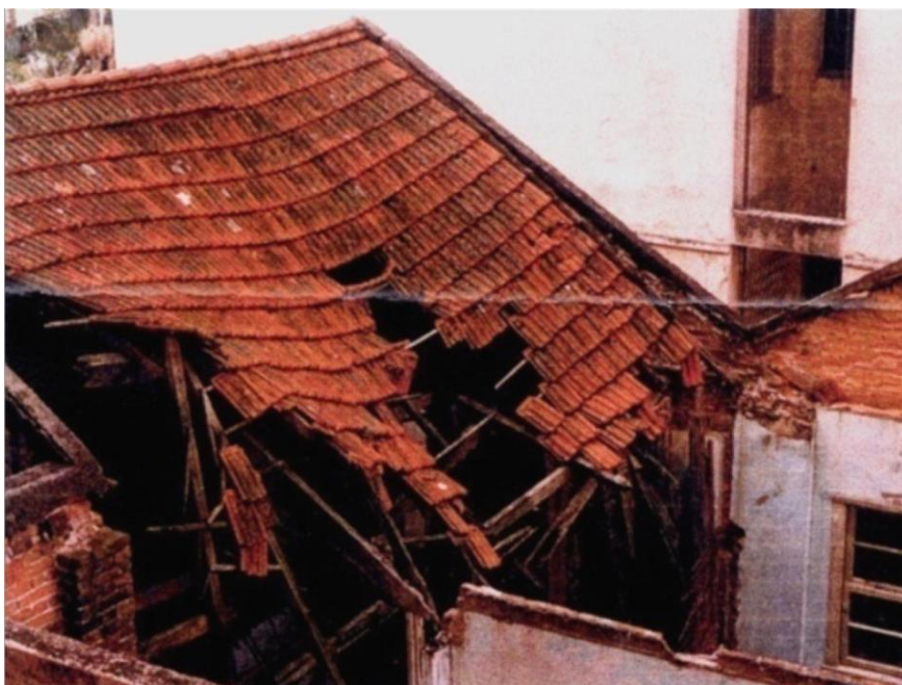
Figura 56: Cobertura antes da restauração. Fonte: cedida por Arquiteta Camila Warpechowski
