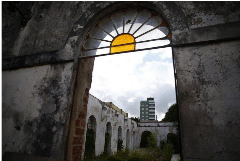
Figura 22 - Parede com alvenaria aparente e fissuras verticais e vitral quebrado.
