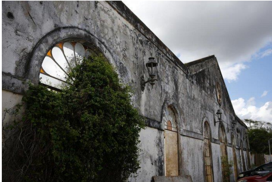
Figura 23 - Parede sujas e com vegetação crescendo
