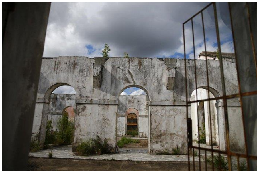
Figura 24 - Parede sujas e com vegetação crescendo
